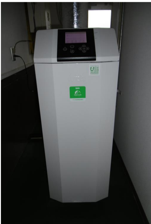
保管庫精密空調機
